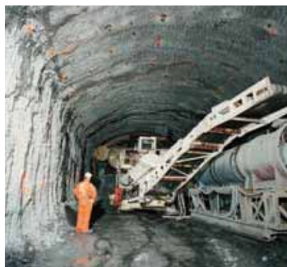
Sandviks datorstyrd fräsmaskin, en så kallad roadheader, ger ökad produktivitet vid tunneldrivning.
